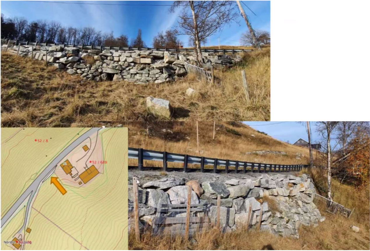
Figur 29. Viser bilder av deformert mur ved ca. P2820
